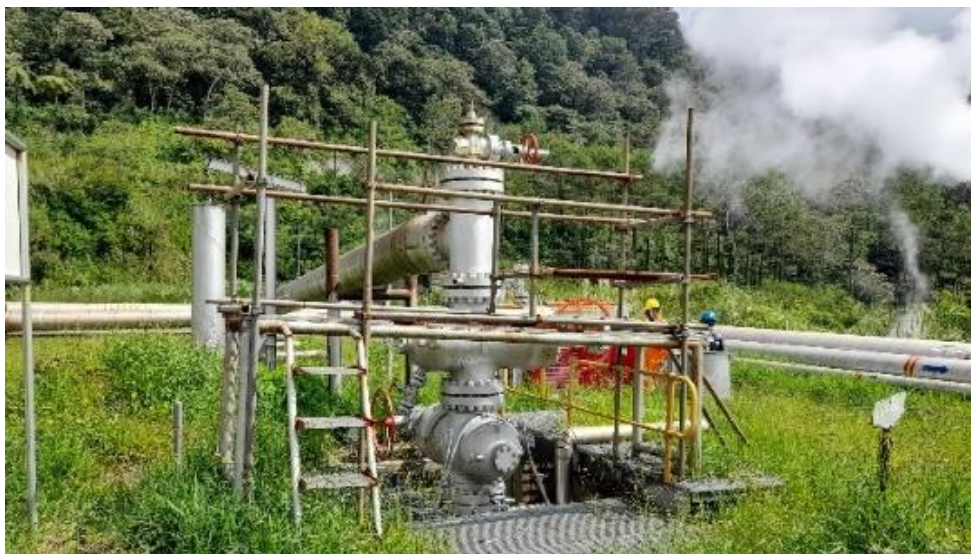
Gambar 1. Pipeline Pada Sumur
